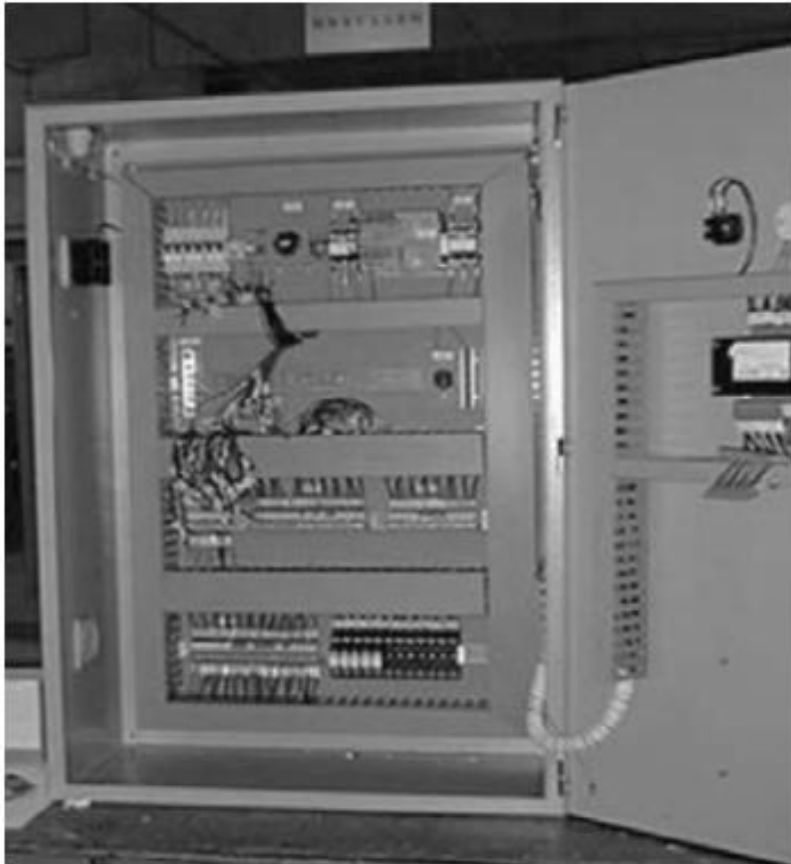
Painél de comando elétrico
